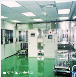
■東光禁油清洗室
